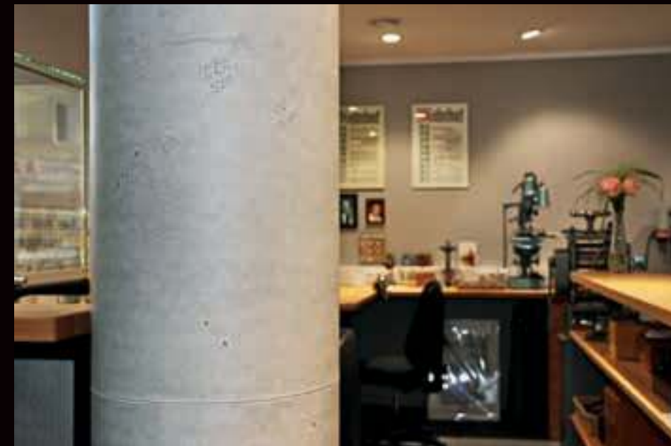
Pomocí elastických a současně dimenzionálně stabilních vrstev se dají ztvárnit i sloupy s betonovým vzhledem
